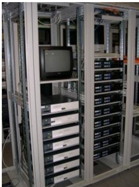
Une baie de serveurs
