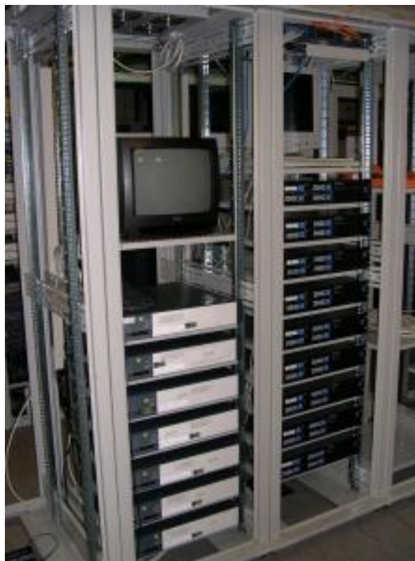
Une baie de serveurs
